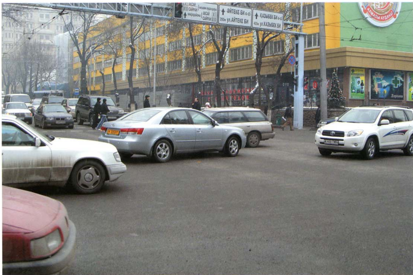
Участок с удвоенной интенсивностью движения и перпендикулярными продолжными нагрузками ул. Фурманова в г. Алматы после двух лет эксплуатации
